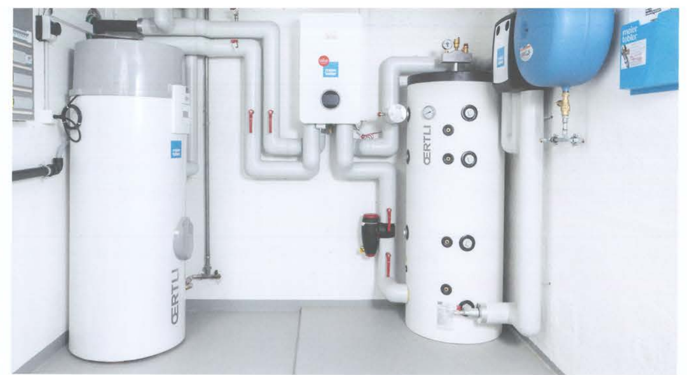
Der alte Heizkeller im neuen Glanz – mit (v.l.) Wärmepumpenboiler Oertli TWH 250EH Pro, Inneneinheit der Wärmepumpe sowie Wärmespeicher Oertli SHW 307.
